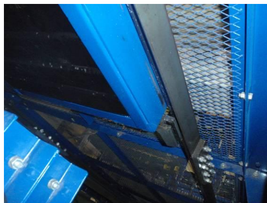
一時保管設備垂直搬送機カウンタウェイトの脱線
