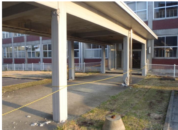
図 2-42 研究棟間渡り廊下柱破損
