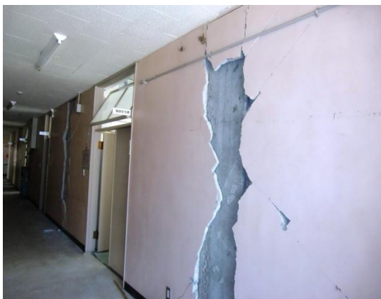
図 2-39 事務 1 棟壁破損
