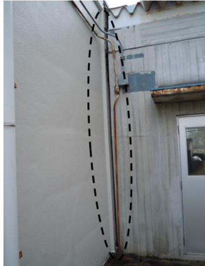
CVCF 室接続部の破損
