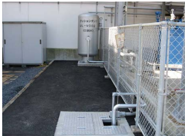
LPG バッファタンク基礎周りの陥没等(復旧後)
