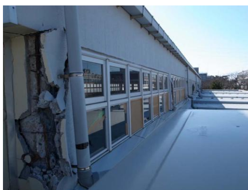
図 2-33 工作工場北側高層部柱破損
