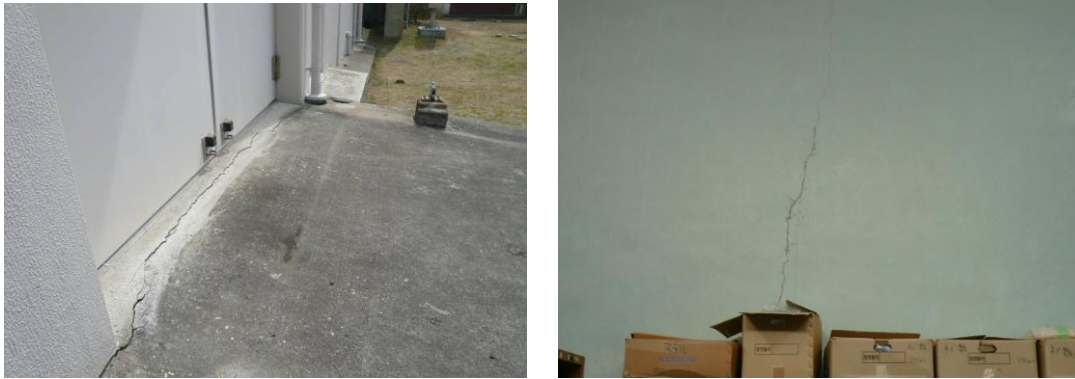
(1) 建家機器搬入口のコンクリート部のクラック (2) 1階内壁のクラック
