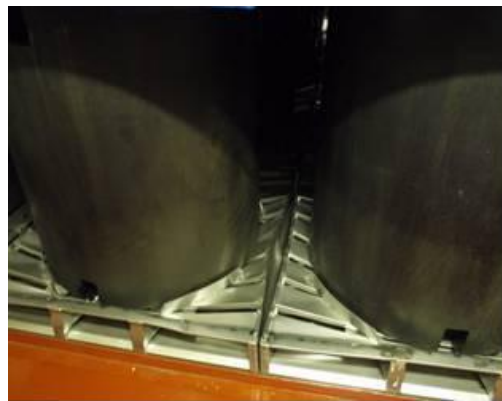
パレット変形の状況
