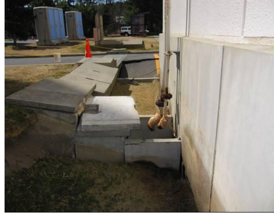
重油配管2本の破断
