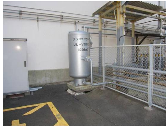
LPG バッファタンク基礎周りの陥没等
