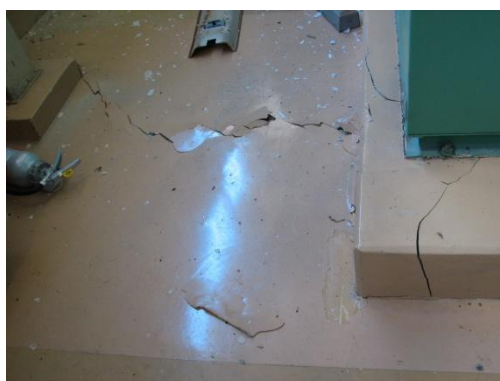
図 2-18 NSRR 機械棟排風機室床面の損傷
