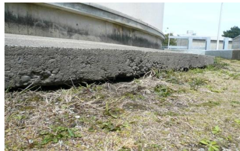
(6) 炉室周辺地盤陥没
