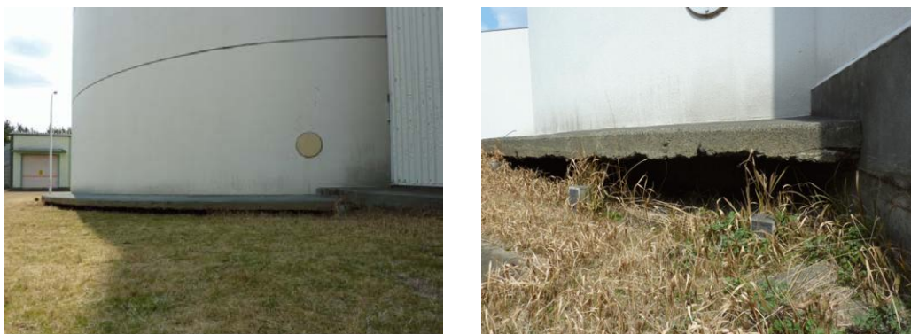
図 2-17 NSRR 原子炉建家周辺の地盤陥没の状況
