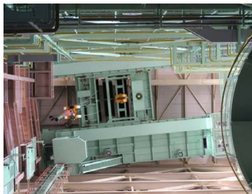
図 2-35 LSTF 天井走行クレーンの脱輪
