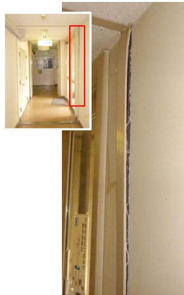
エキスパンションの変形（建家つなぎ部）
