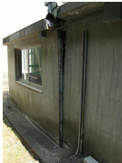
放射性廃液貯槽室の建家つなぎ部の隙間状況（建家外部）
