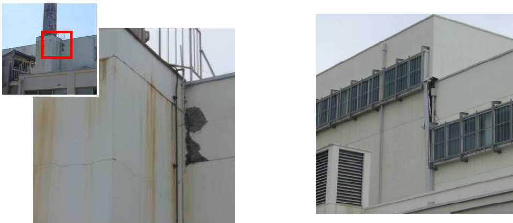
主排気筒基部の亀裂
