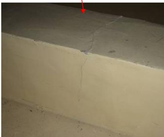
廃液貯槽室1 防液堤及び防液堤内の亀裂
