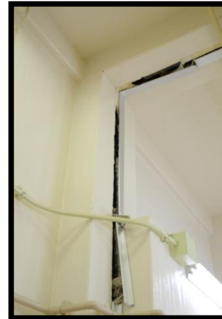
内側からみた亀裂
