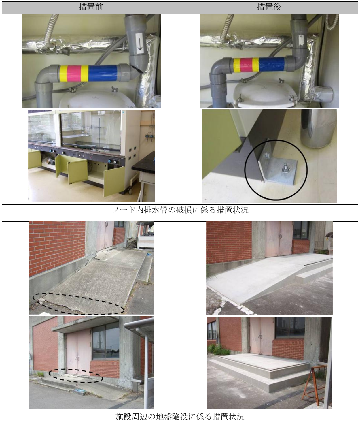
図 3-15 JRR-3 実験利用棟（第 2 棟）の被災箇所への主な措置状況
