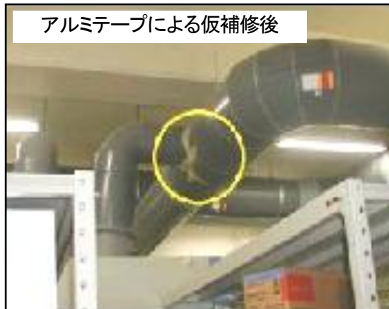
フードの排気ダクトの接続部分離及び亀裂
