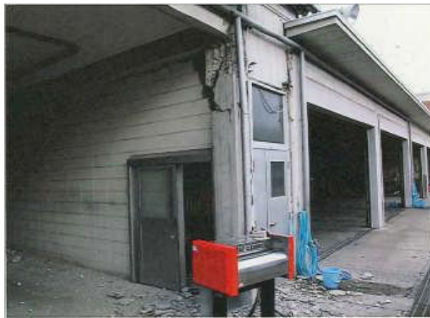
図2-44 車庫コンクリート柱破損
