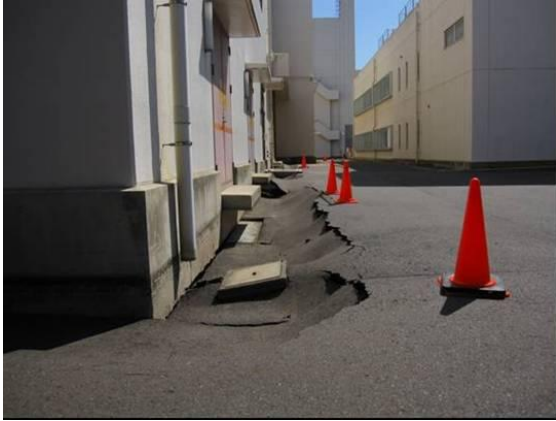
建家周りの陥没
