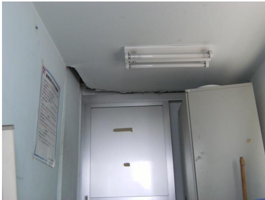
放射性廃液貯槽室の建家つなぎ部の隙間状況（建家内部） 隙間状況
