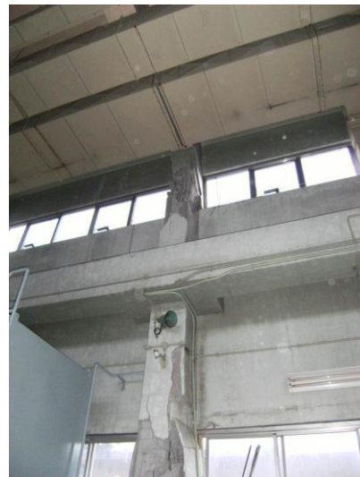
15tonクレーン室内柱の座屈状況 (上部)
