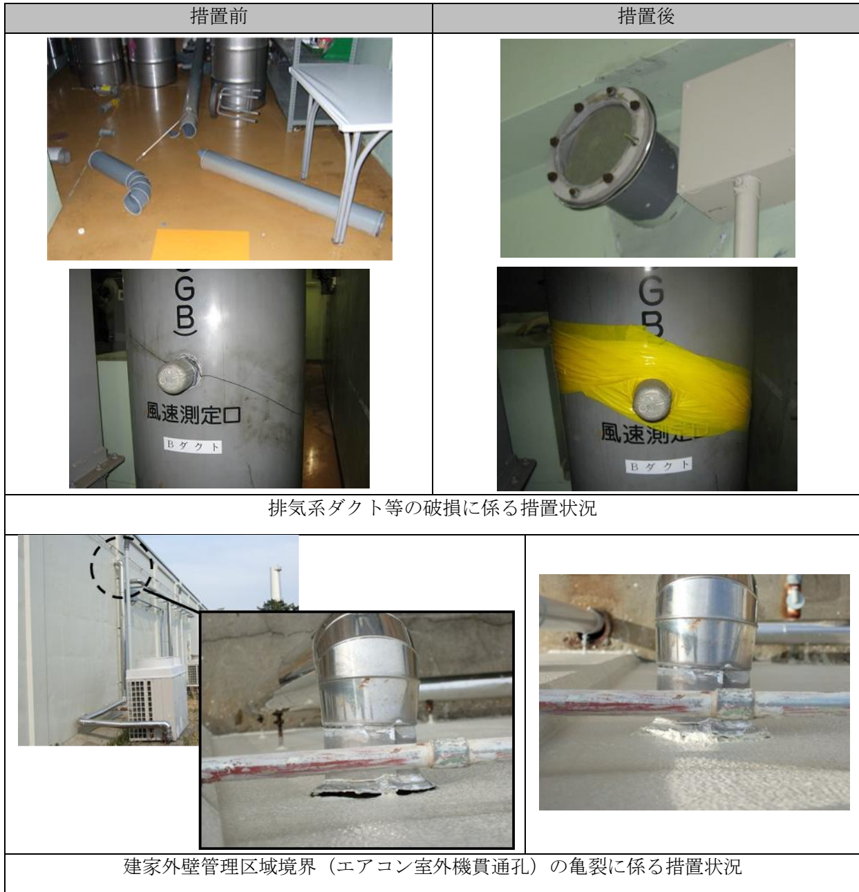
図 3-13 プルトニウム研究 1 棟の被災箇所への主な措置状況
