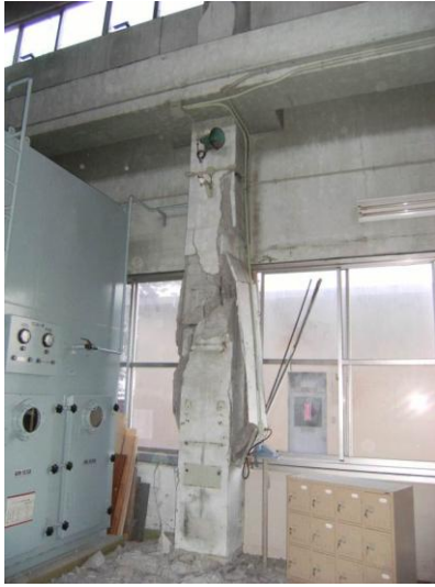
室内柱の座屈状況（下部）
