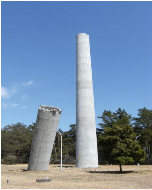
排気筒の倒壊状況
