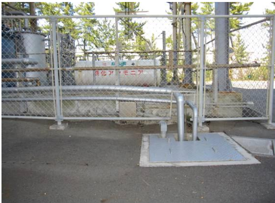
LPG 配管等の変形
