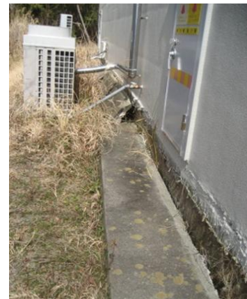
施設周辺の地盤陥没
