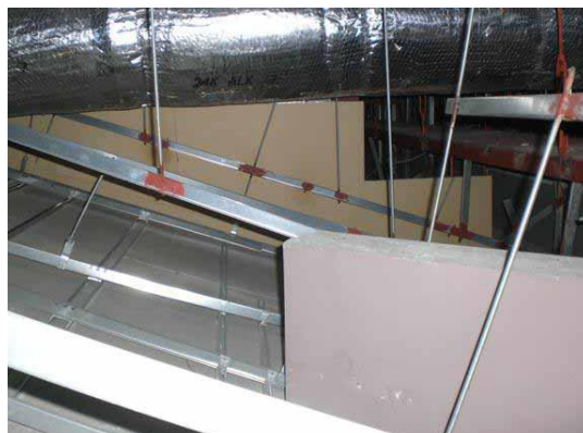
図 2-46 鉄骨下地破損
