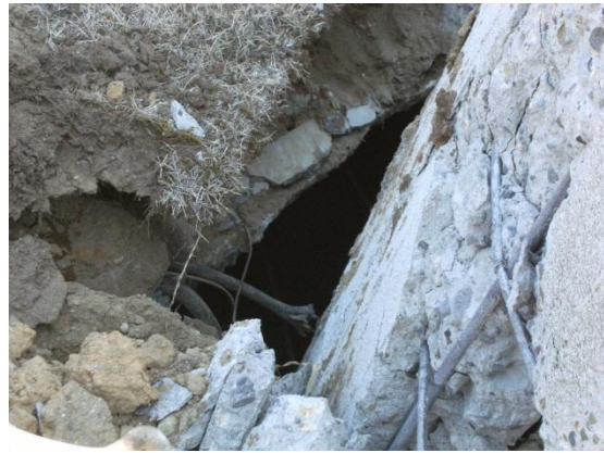
コンクリートダクトの損壊状況
