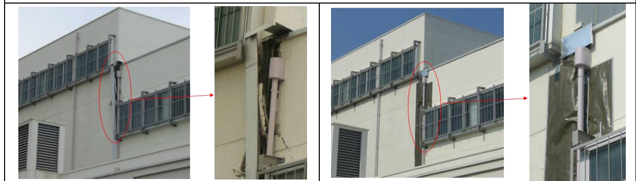
建家つなぎ部一部損壊に係る措置状況
