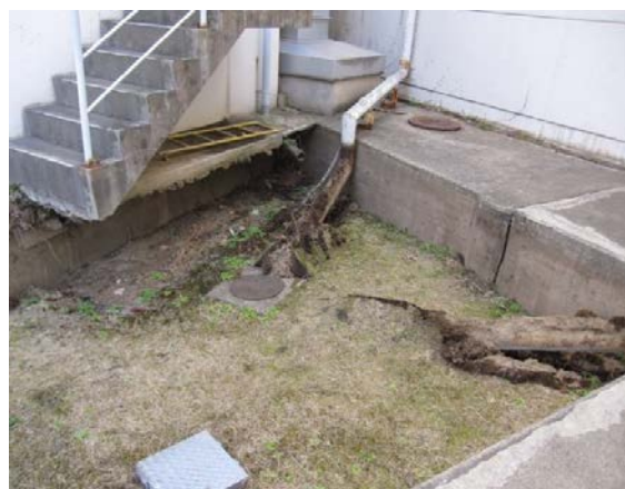
図2-20 JRR-3 原子炉建家と実験利用棟の間の地盤陥没
