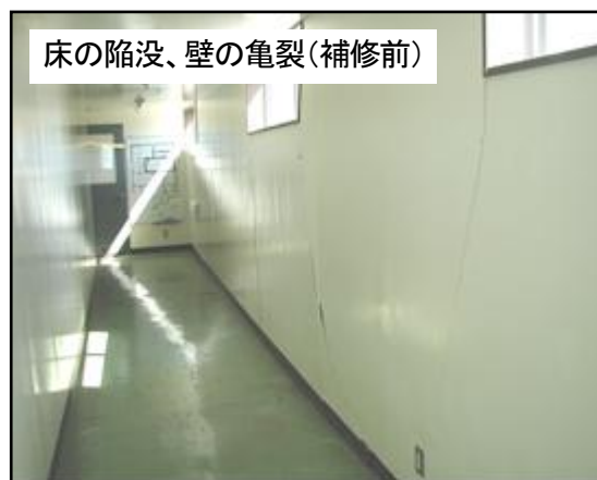
1階廊下床の一部陥没及び壁の亀裂
