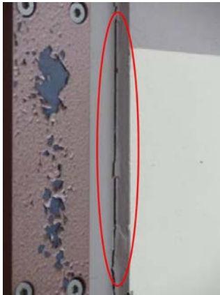
管理区域内壁の隙間
