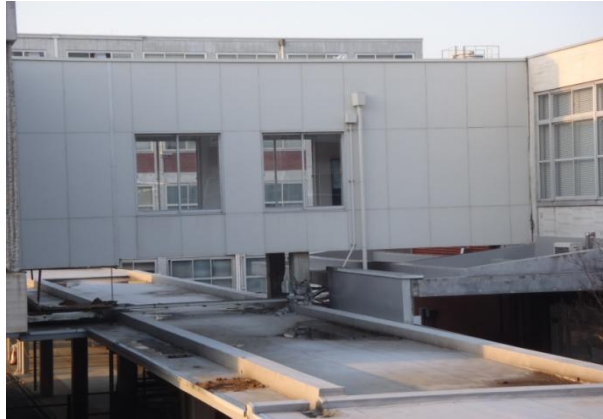
図 2-41 渡り廊下支柱破損
