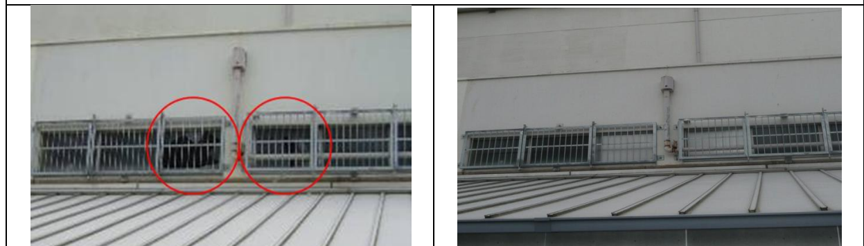
管理区域境界窓ガラスの破損に係る措置状況
