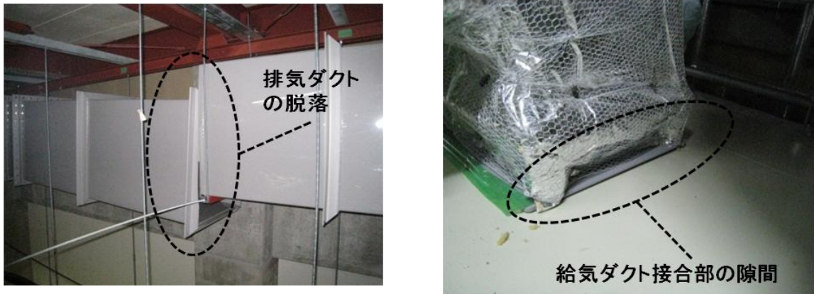
給排気系ダクトの損傷
