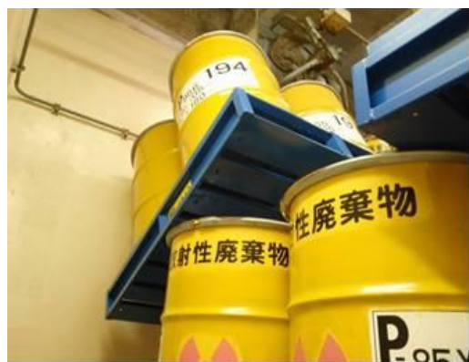
ドラム缶荷崩れの状況
