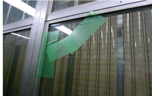
(4) 制御室ガラスの損傷
