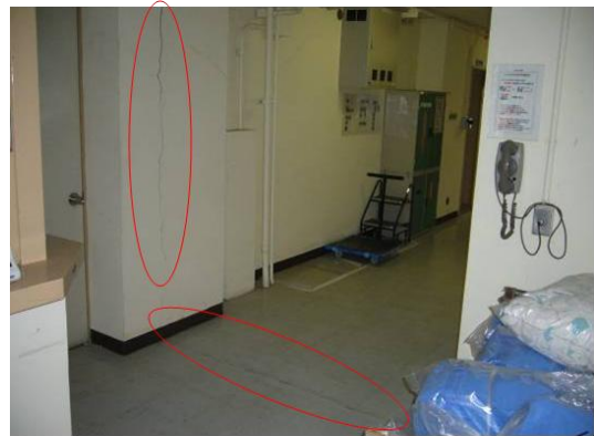
管理区域境界床の亀裂
