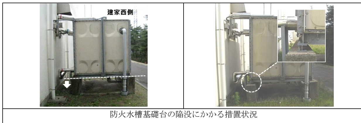
図 3-16 高度環境分析研究棟（CLEAR）の被災箇所の主な措置状況(2/2)
