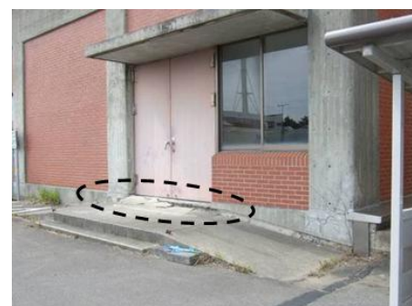
施設周辺の地盤陥没
