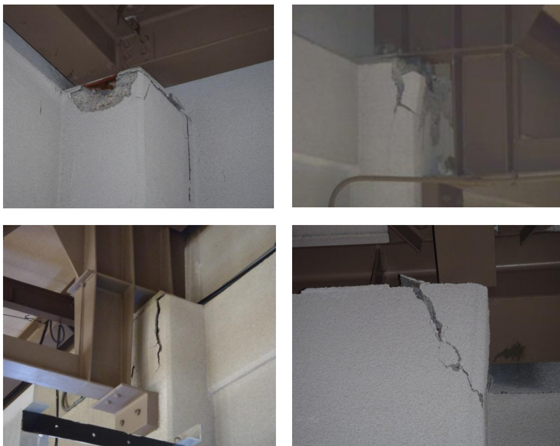
図 2-30 第2 廃棄物処理棟支柱上部の被害状況
