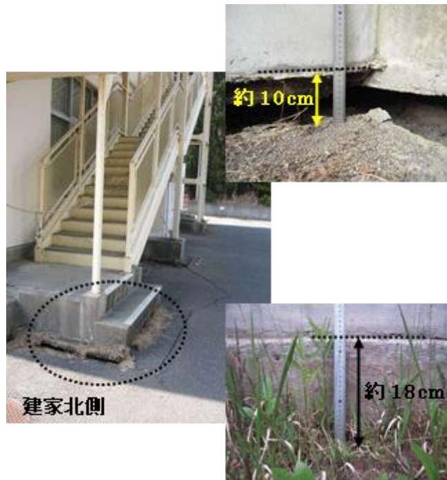
施設周辺の地盤陥没
