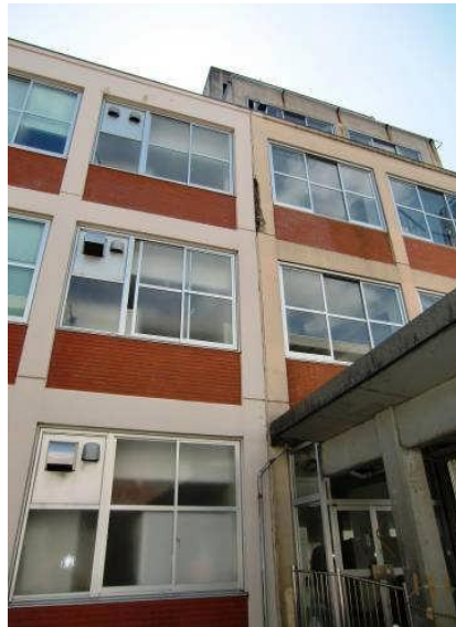
図 2-38 第 3 研究棟外壁破損
