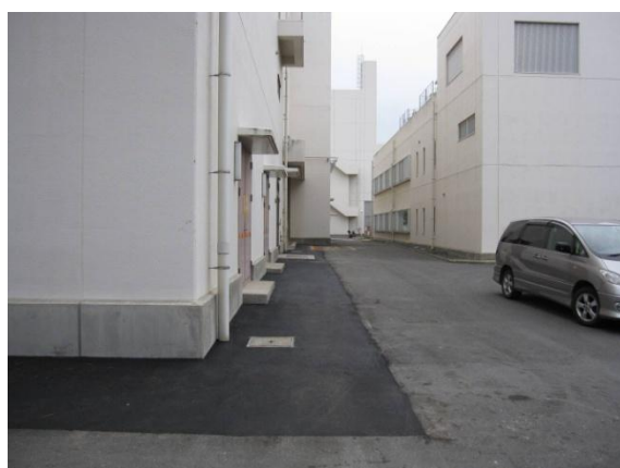
建家周りの陥没（復旧後）
