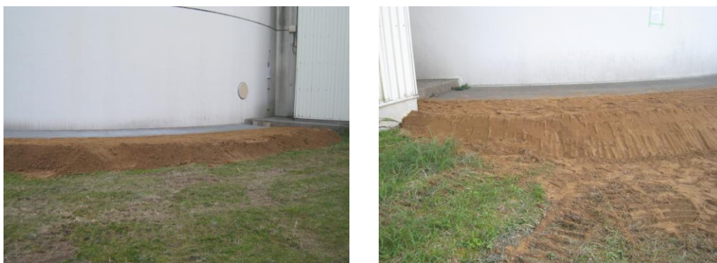
図3-5 NSRR原子炉建家周辺の地盤沈下応急復旧状況
