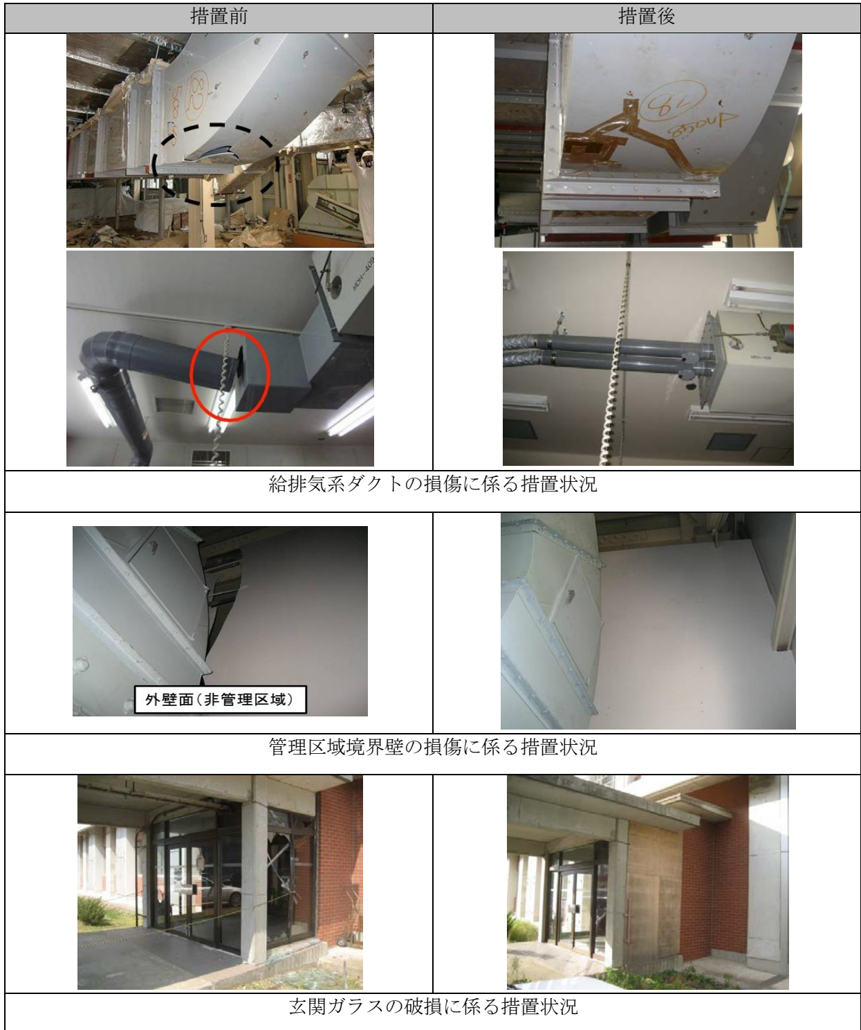
図 3-14 第 4 研究棟の被災箇所の主な措置状況
