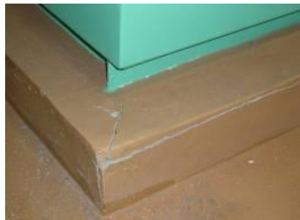
フィルターユニット基礎部の亀裂
