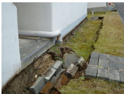
(1) NUCEF 実験棟周辺の地盤陥没
