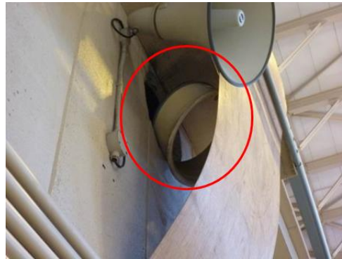
サービスエリア給気口の脱落
