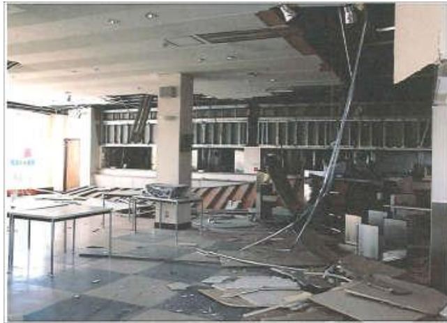
図2-43 食堂2階天井崩落
