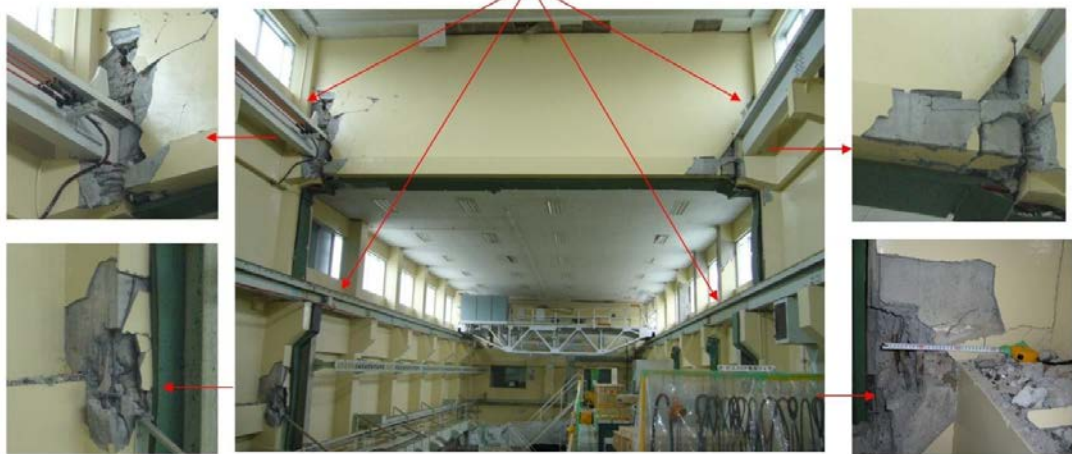
天井走行クレーンのレール支持部損傷
