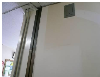
(7) 居室内側クラックの復旧
