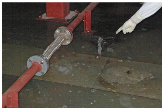
(2) 排気筒下部トレンチ内の地下水の浸入
