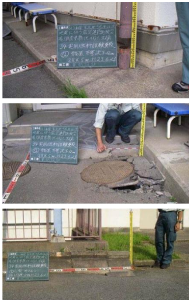
建家周辺の地盤陥没など
