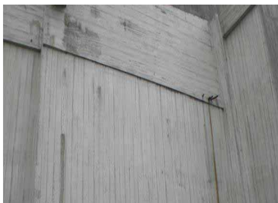
図 2-45 大講堂外壁破損
