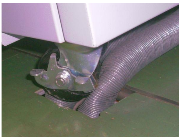
図2-27 押し潰されたUPSの入出力電線管
