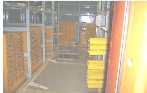
(2) 燃料キャビネット破損
