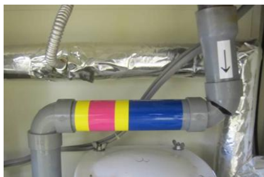
フード内排水管の破損
