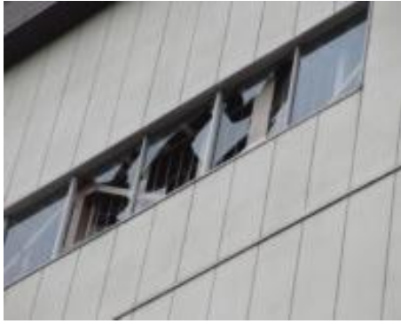
窓ガラスの破損
