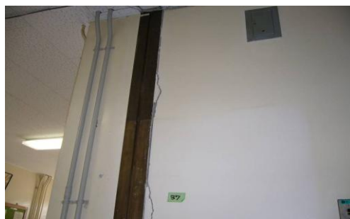
(7) 居室内側のクラック
