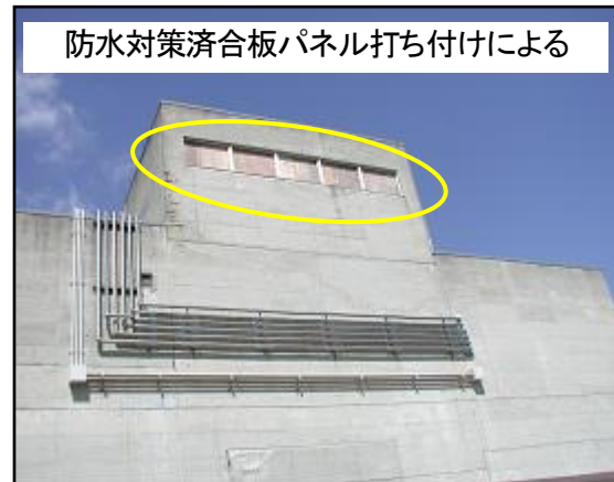
3階南側窓ガラスの損壊
