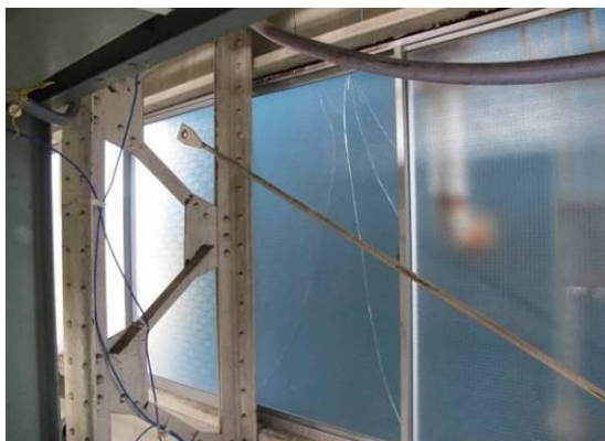
図 2-36 機械化工特研鉄骨ブレース破損
