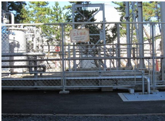
LPG 配管等の変形(復旧後)
