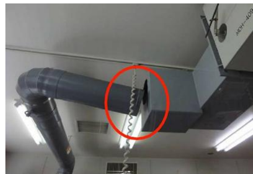
給排気系ダクトの損傷
