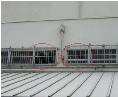
管理区域境界窓ガラス破損
