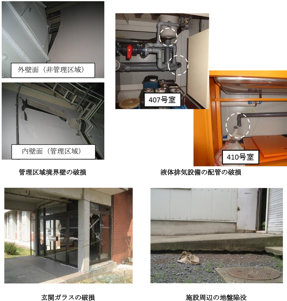
図 2-11 第 4 研究棟の主な被災状況 (2/2)
