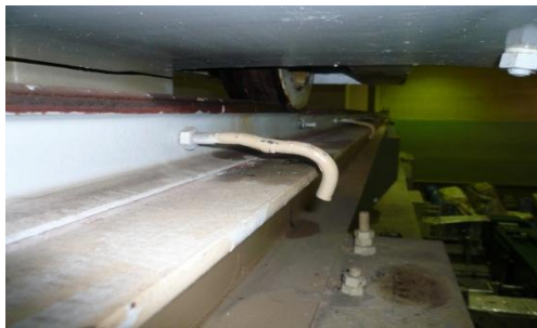
(5) 天井クレーンフックボルトの損傷
