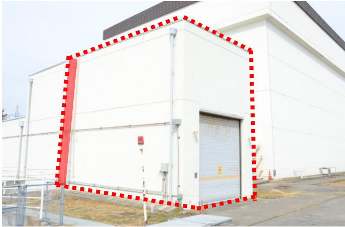
ローディングドックの亀裂
