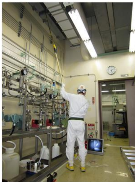
(4) 壁高所のひび割れ確認
