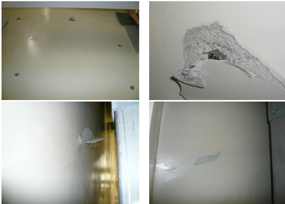
(4) 制御室壁及び階段室の塗装はがれ
