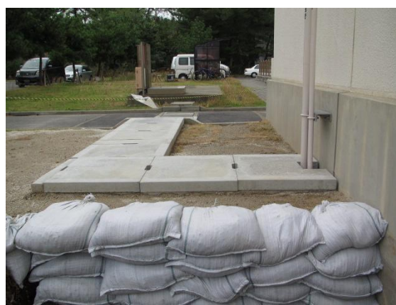
重油配管 2 本の破断（復旧後）
