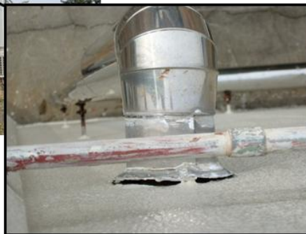
建家外壁管理区域境界（エアコン室外機貫通孔）の亀裂
