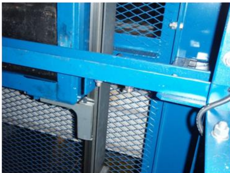
一時保管設備垂直搬送機カウンタウェイトの脱線(復旧後)
