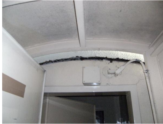
燃料貯蔵庫の建家つなぎ部の隙間状況（建家内部）
