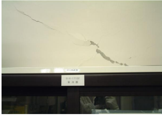
(3) 実験棟 A 管理区域内壁のひび割れ
