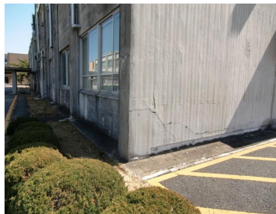
図 2-40 事務 1 棟外壁破損
